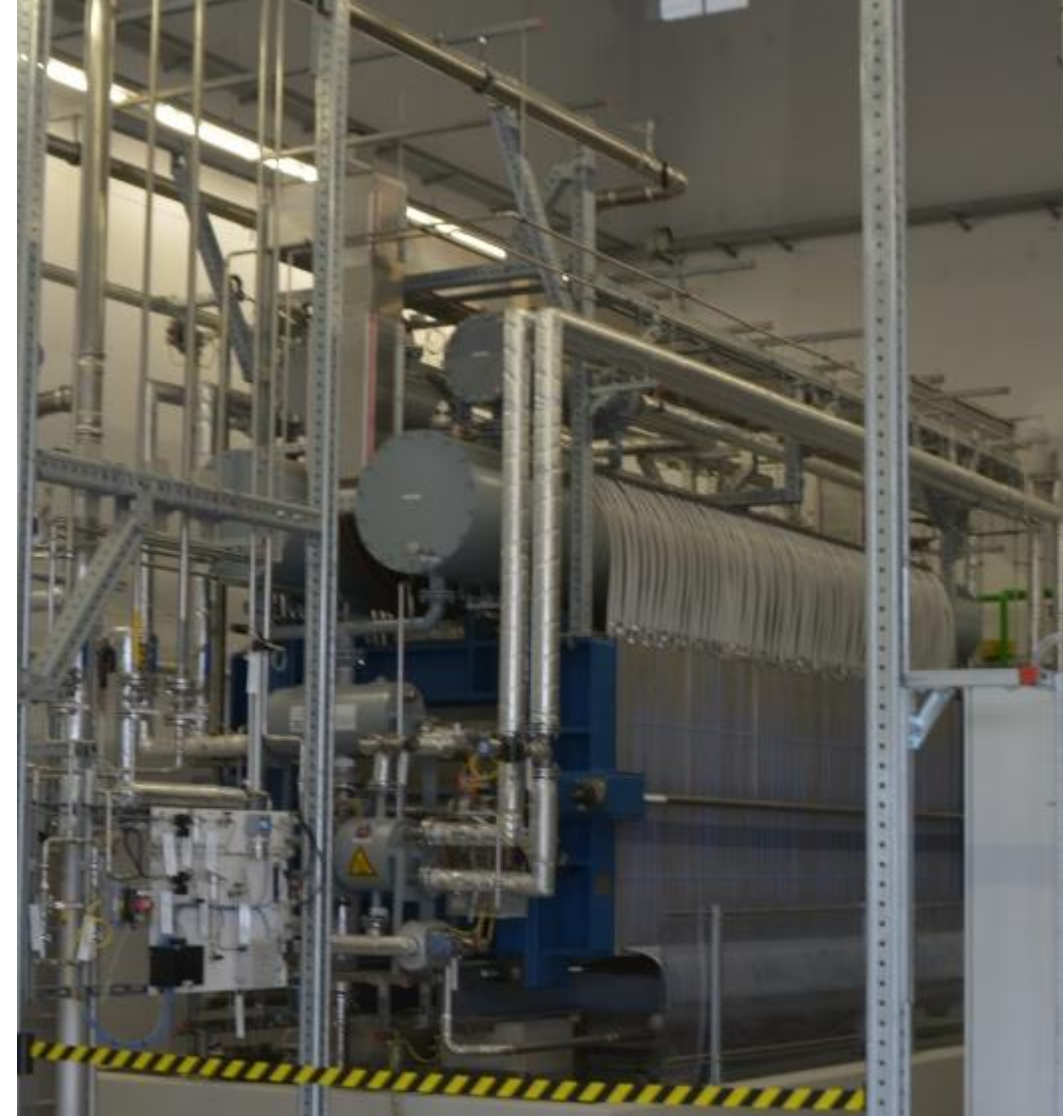
Alkalischer Elektrolyseur 2 MW Stand der Technik
